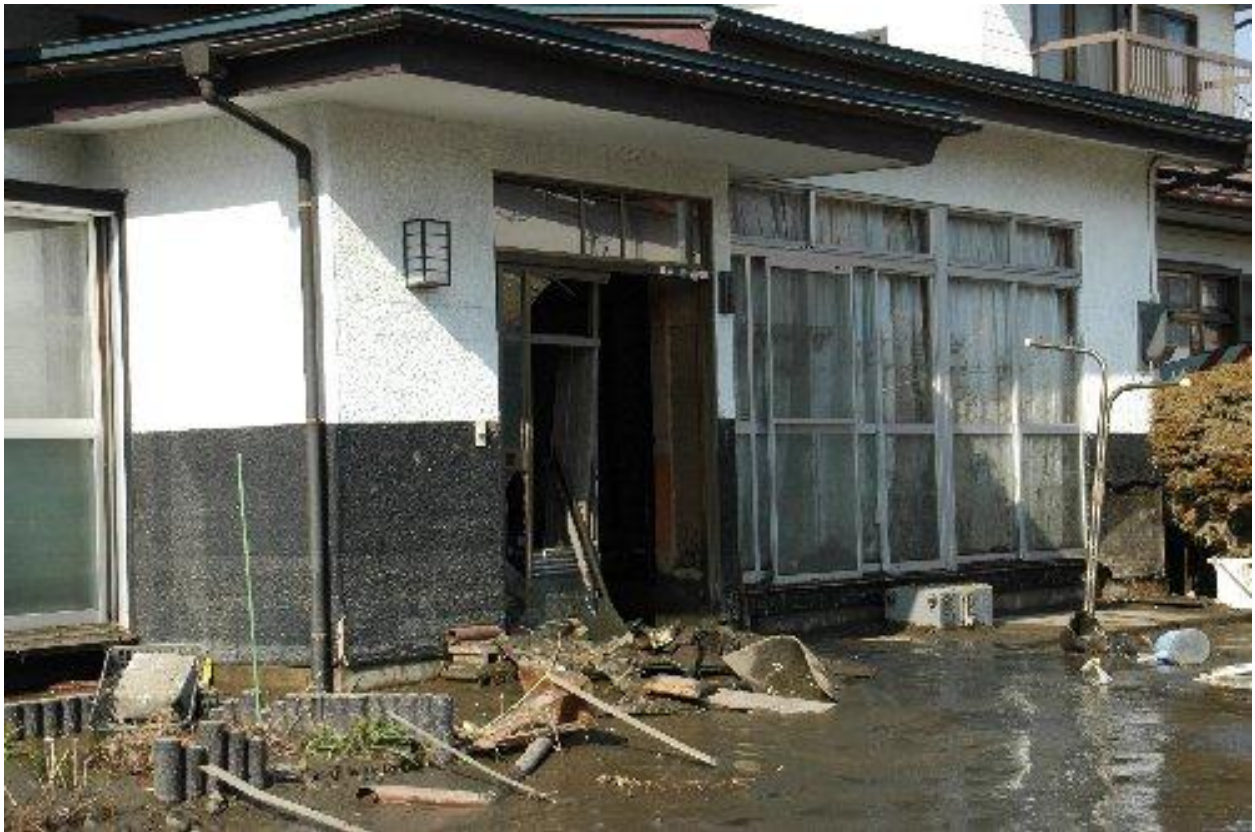
住宅には 2m 位の浸水の跡(上納)
