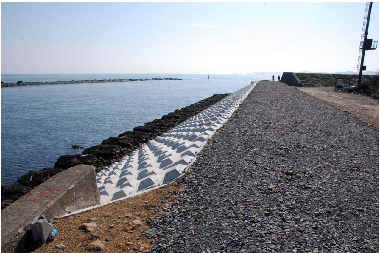
仮修復された堤防
