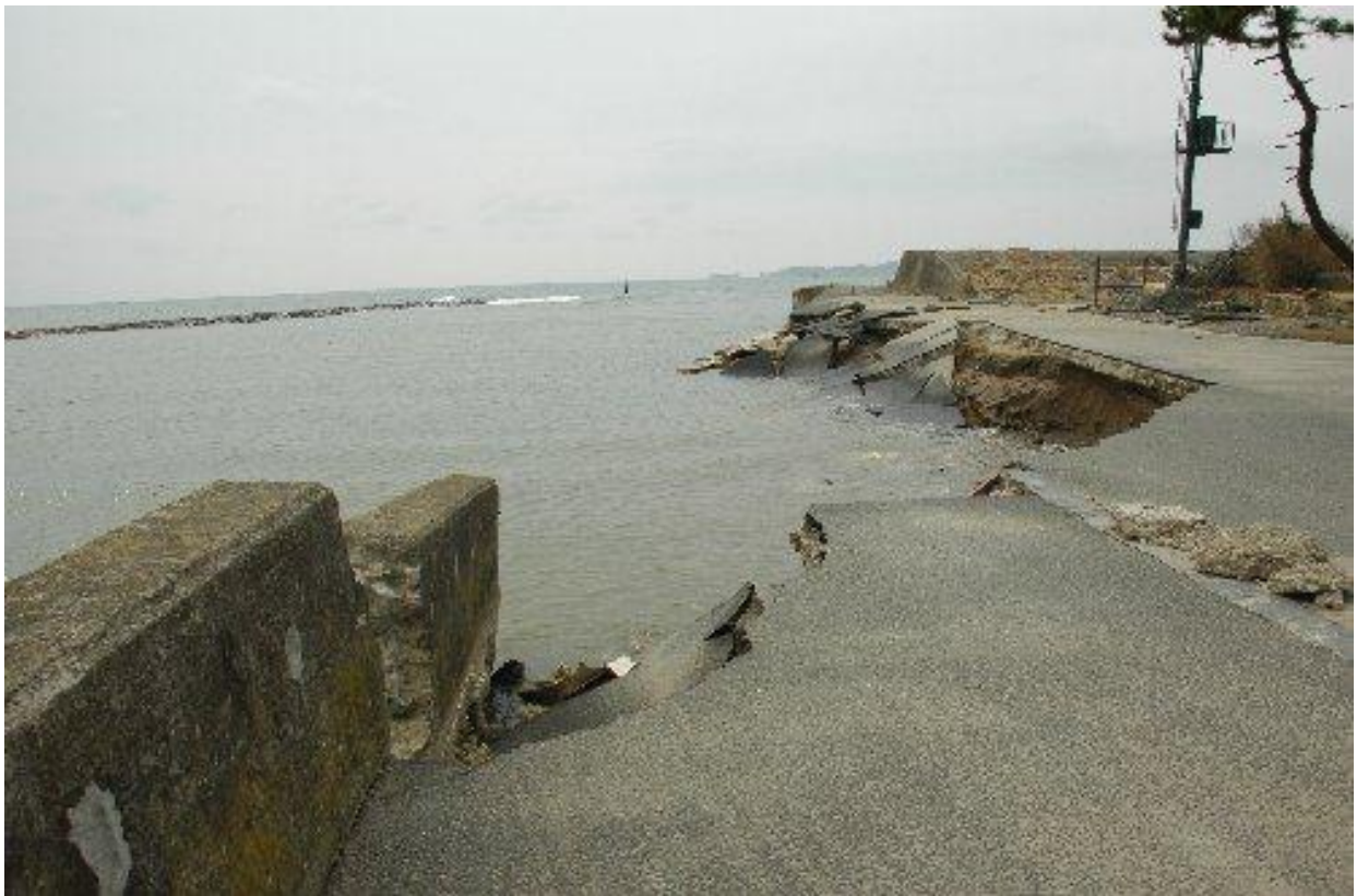
堤防が津波により破損・流出
